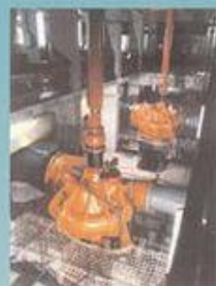
Usine de relèvement d'eau soie de Colombes, salle des pompes Bergeron-Rotau, vers 1990.
