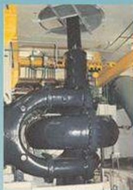
Usine de Choisy-le-Roi, pompe de refoulement Bergeron, installée en 1930.
