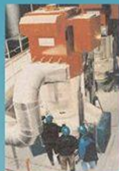
Usine de traitement d'eau potable de Neuilly-sur-Marna, pompes de refoulement Rotau, 1975.
